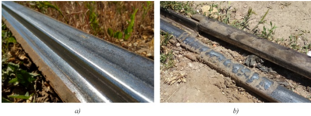
Рис. 1 Дефекты колеи в эксплуатации: а – увеличение ширины колеи в кривом участке, б – некорректный стык рельс
