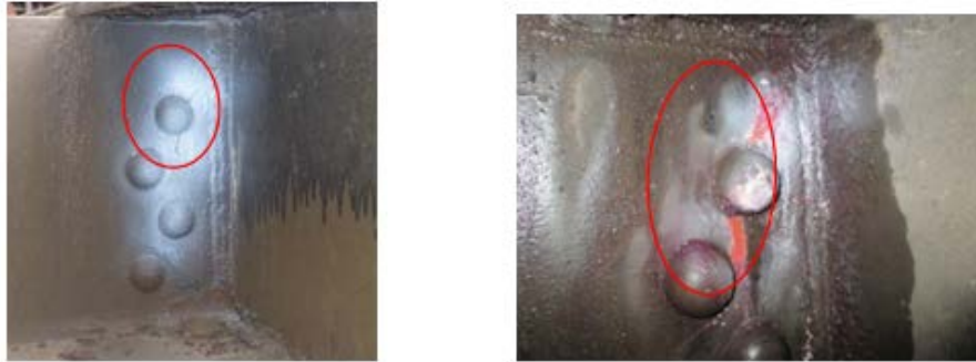
Рисунок 4 – Дефекти у вигляді тріщини хребтової балки виявленого за допомогою магніто-порошкового та капілярного методів НК
